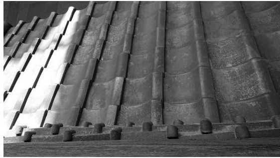
写真4：菊坂跡見塾2階からみた落ちる危険のある瓦
